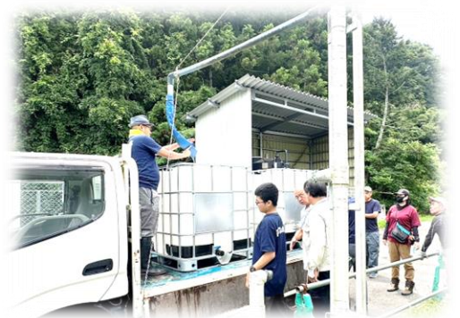
富山浄水場から水道水をタンクに注水
