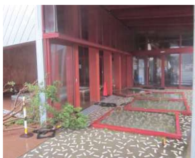
飛ばされた足湯の扉
