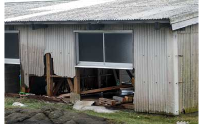
波が貫通した漁業倉庫
