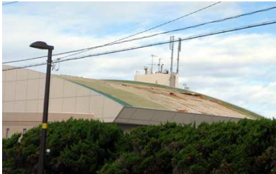
北風で屋根の断熱材が剥がれた
